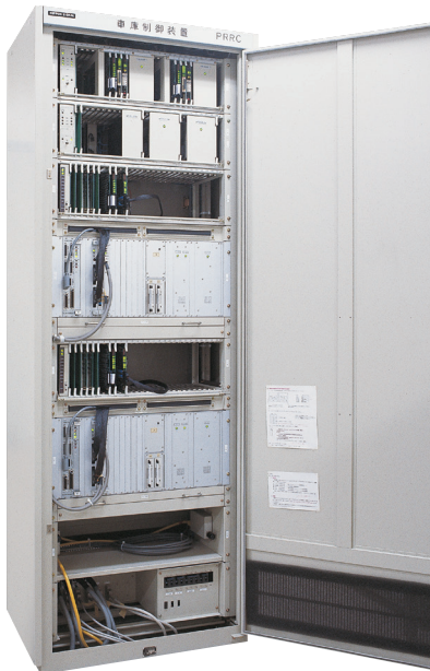
■ 車庫制御装置
